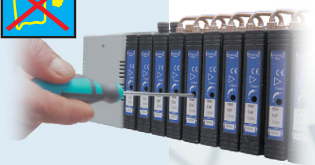
Verstärkungseinstellung an der Kopfstation
